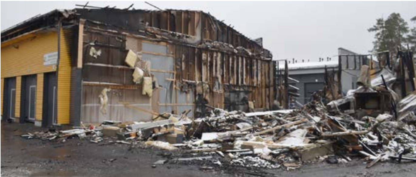
Branden kunde begränsas till den del av byggnaden där bageriet var beläget. Vad man inte visste var att det övernattade personer i den motsatta delen av byggnaden.
