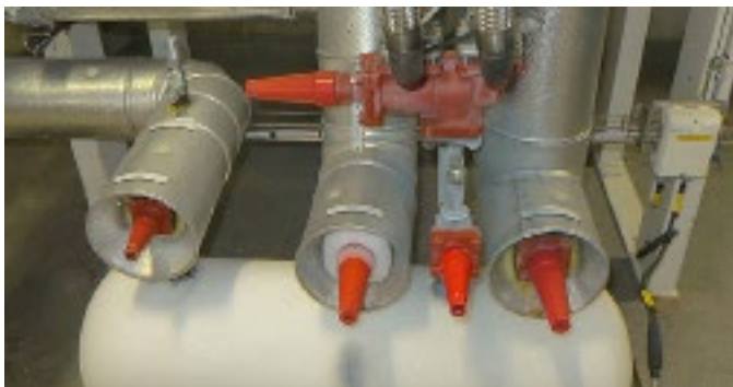
Kranarna till ammoniaktanken där en ventil stod öppen och läckte ut ammoniak.
