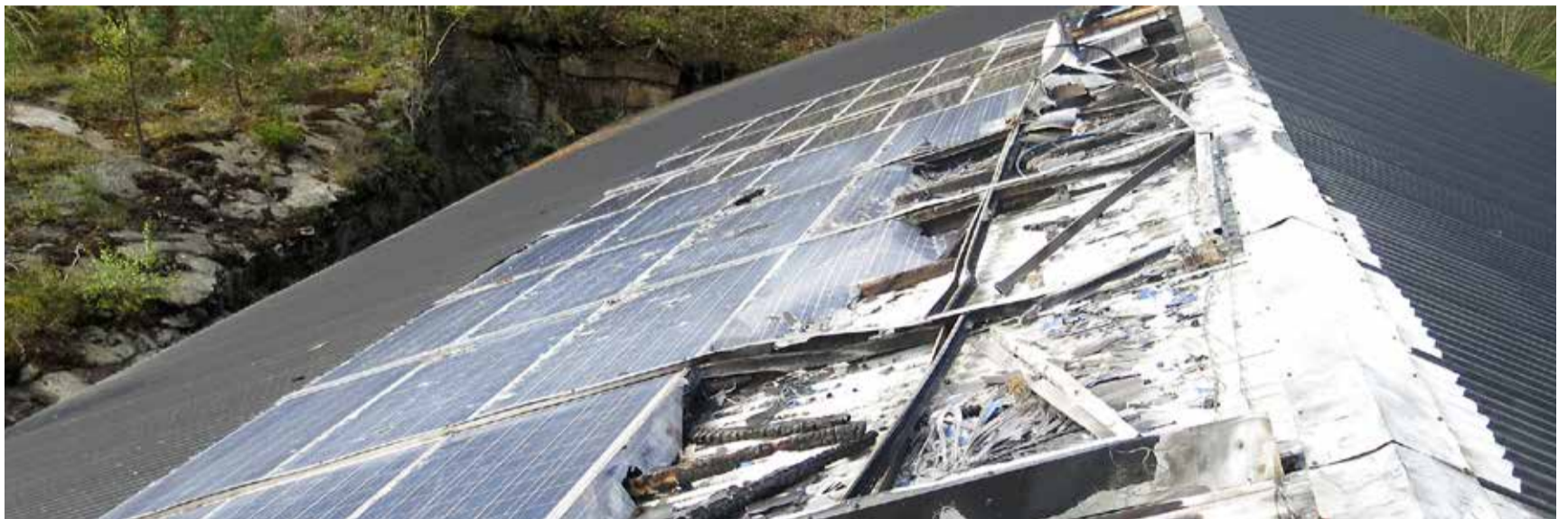
Det var mycket som gjordes fel när solcellsanläggningen monterades, av slarv eller okunskap. Installationen hade inte följt svensk standard.
