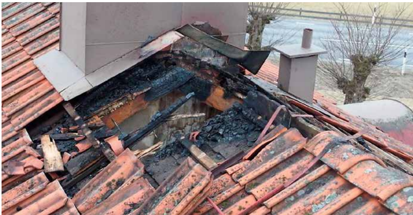
Brandområdet har frilagts och det syns tydligt att branden har kommit utifrån, gnistor har tagit sig under takpannorna.
