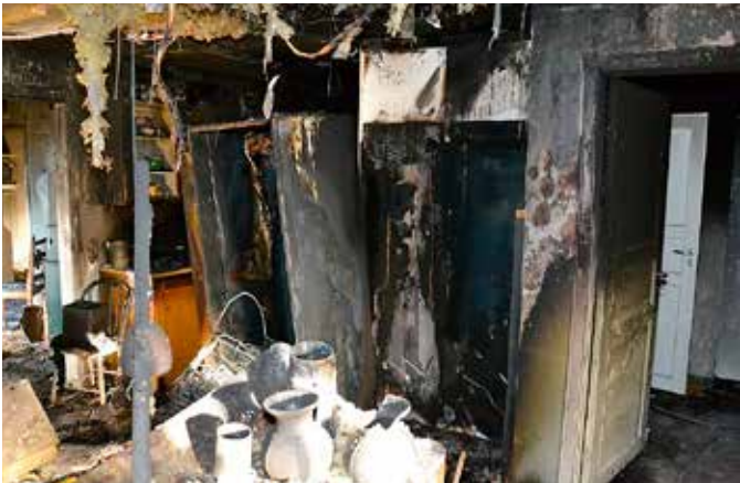
Till vänster om dörröppningen kan ett "brand-V" skimras där frysen stått. FOTO: RÄDDNINGSTJÄNSTEN
