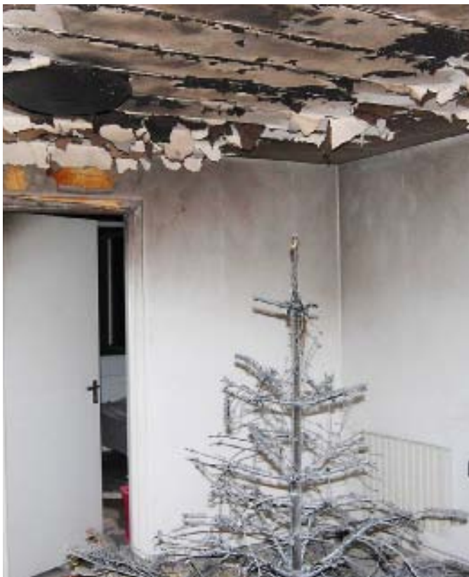
Vid branden i Malmö fanns en pulverbrandsläckare i hushållet som användes för att släcka branden. Händelsen fick ett lyckligt slut.
