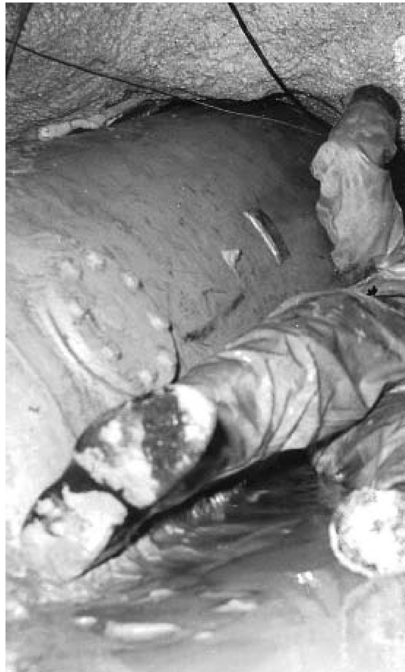
Tunnelraset i Stockholm stängde in två arbetare i fem dygnen. Insatsen med
