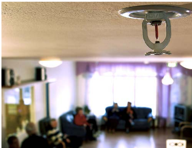
Sprinkler (eller motsvarande skydd) måste krävas enligt lag i lokaler för personer som har små förutsättningar att själva sätta sig i säkerhet, både vid nybyggnad och retroaktivt, anser Mattias Delin, Föreningen för brandteknisk ingenjörsvetenskap.
