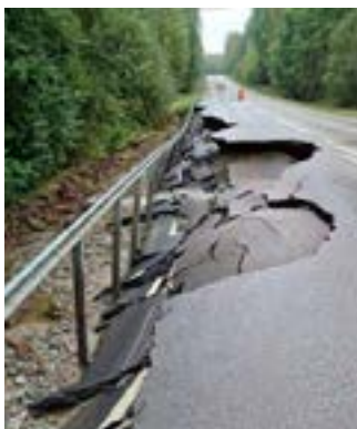
Så här såg det ut på länsväg 786 i höstas.
