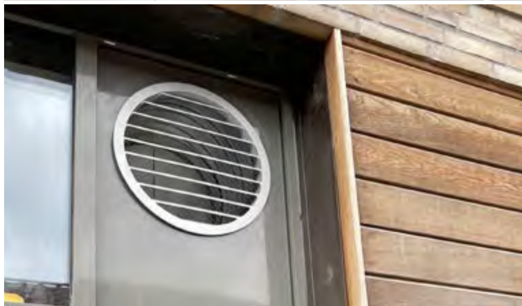
Exempel på åtgärd med tilluftsventil i fasad med ventilationsrör till hisschaktet.
