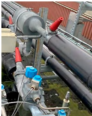
Ventilcentral som montörerna stängde av när det börjat läcka ammoniak.
