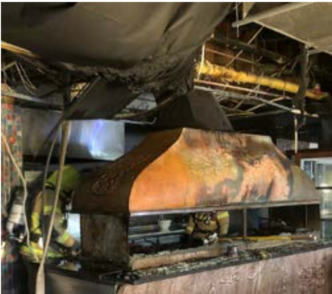
I samband med branden upptäcktes att viktiga uppgifter kring brandskyddet och installationen av kolgrillen saknades.
