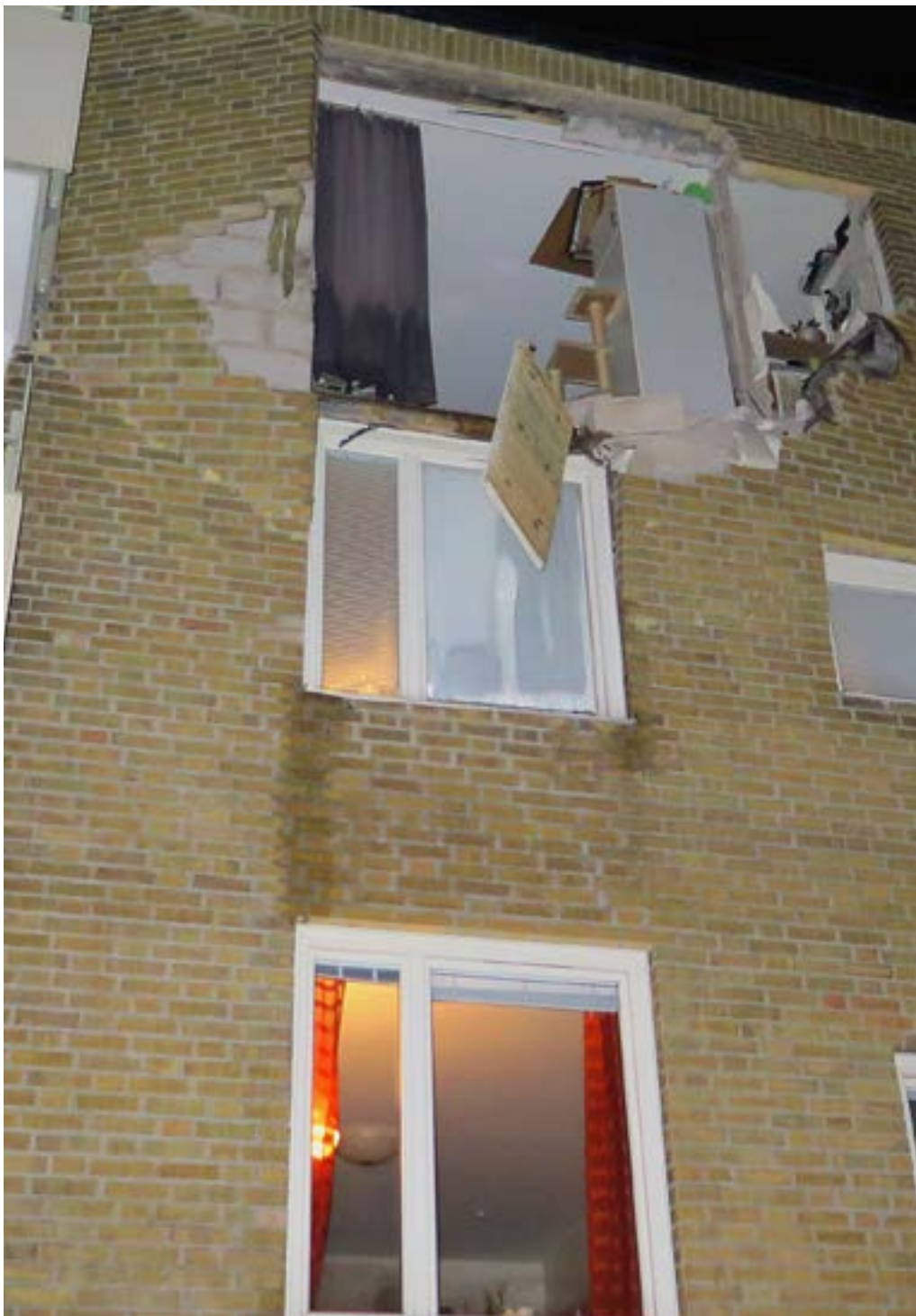
Ett stort hål i ytterväggen på tredje våningen var vad som mötte räddningstjänsten när den kom till platsen. En kvinna fick hjälpas ut ur lägenheten.
